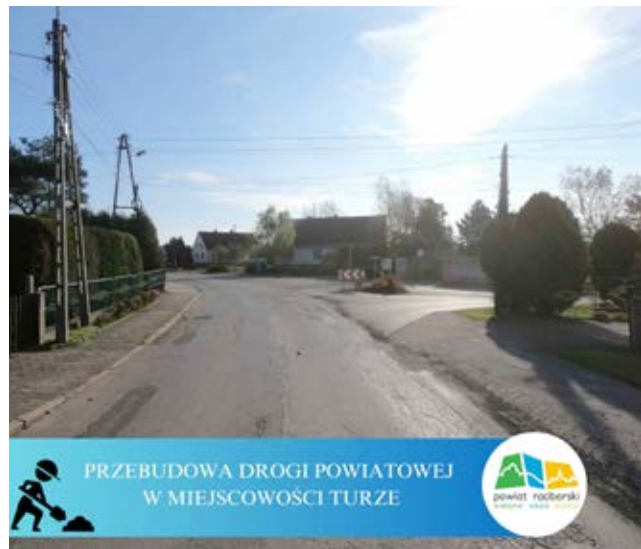
Przebudowa drogi powiatowej nr 3509S w miejscowości Turze od wału przed mostem na rzece Rudzie
