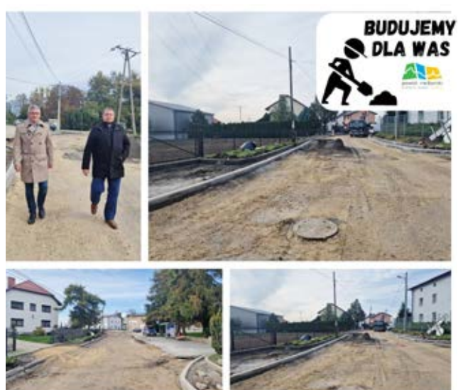
Modernizację odcinka ul. Wiejskiej od skrzyżowania z Węgierską do tzw. wąskiego gardła za ul. Zbożową, przy wylocie na Zerdziny
